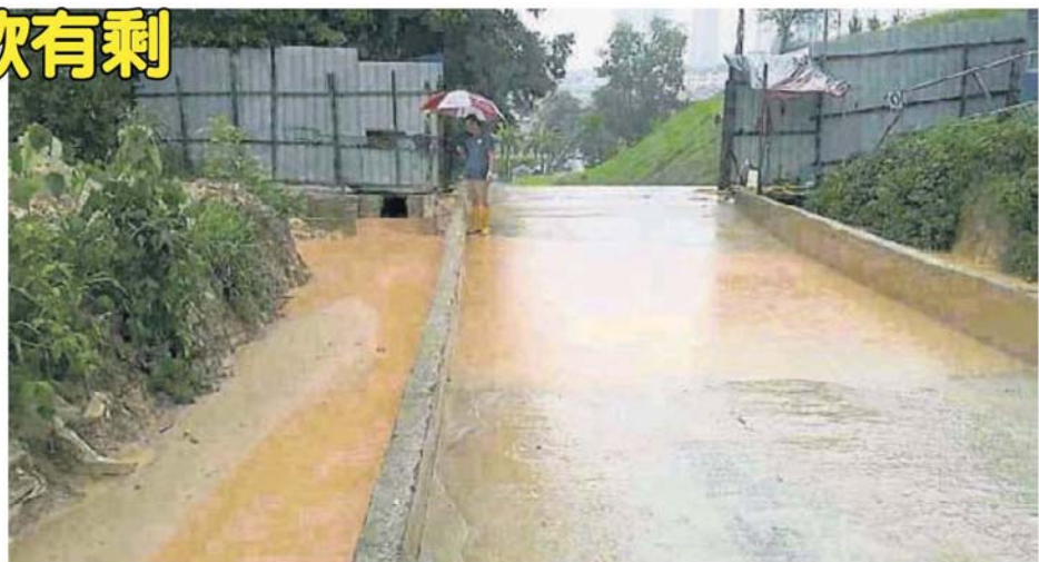
■首都镇第3区后方有工程施工中，以致泥水流入住宅区的路面。
