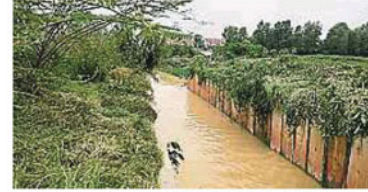
▲直径5.5公尺的河道被指不能负荷排水量，必须拆除。
